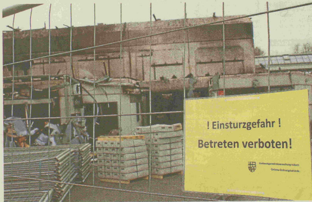
Ein hoher Zaun wurde rund um den abgebrannten Gebäudekomplex aufgestellt. Es herrscht Einsturzgefahr.
